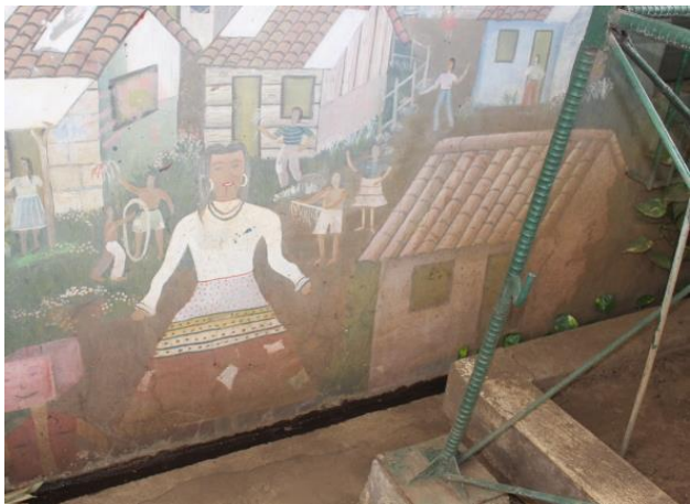
Figura 1 Humedad de obra en los murales.
